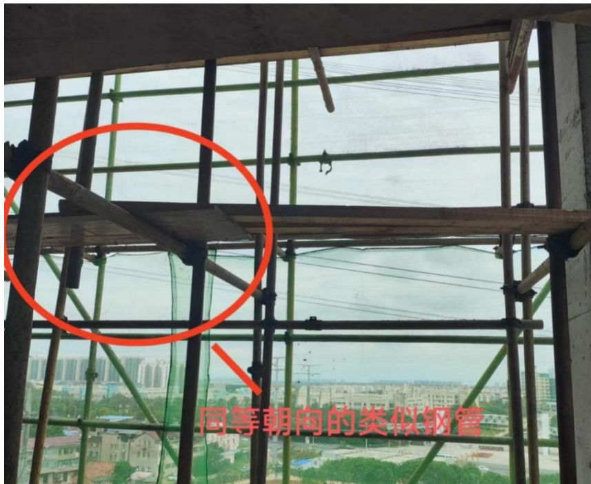
图 2 事故钢管掉落处照片
