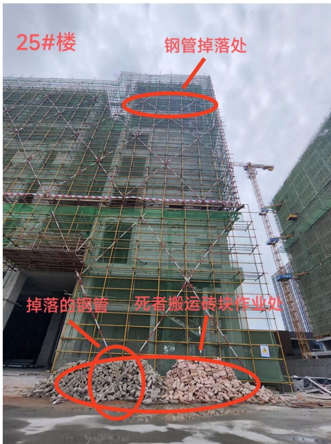
图 1 事故现场一楼照片
